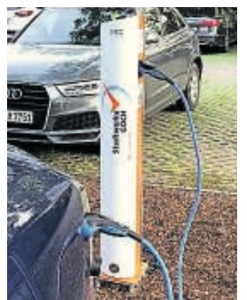
Auf dem LGC-Parkplatz gibt es eine Ladestation für E-Autos.
